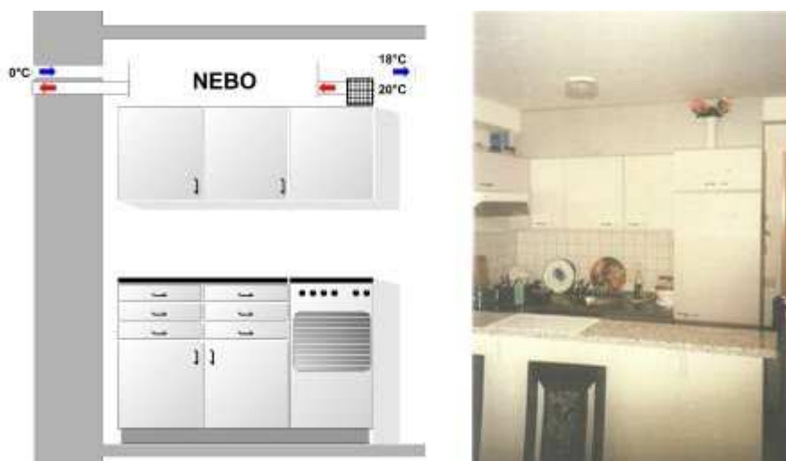
Obrázek 25 - Větrací jednotka s rekuperací tepla nad kuchyňskou linkou
